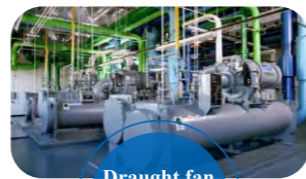
Draught fan & Water pump
